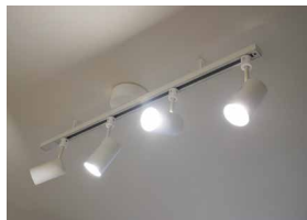
⑤ ダクトレール
