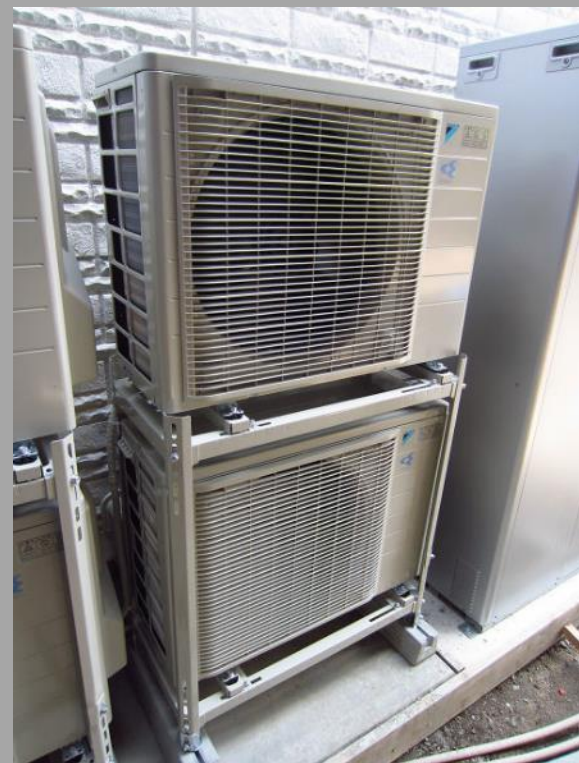
エアコン室外機 2段設置
