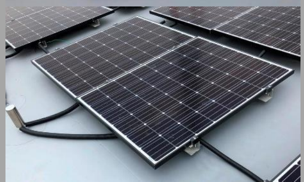
太陽光発電（陸屋根設置型）
