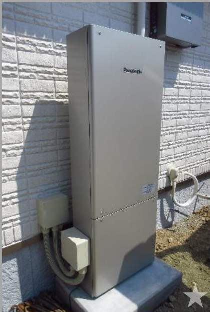
パワーステーション
