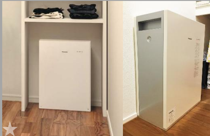
蓄電ユニット (5.6KWh屋内型)
