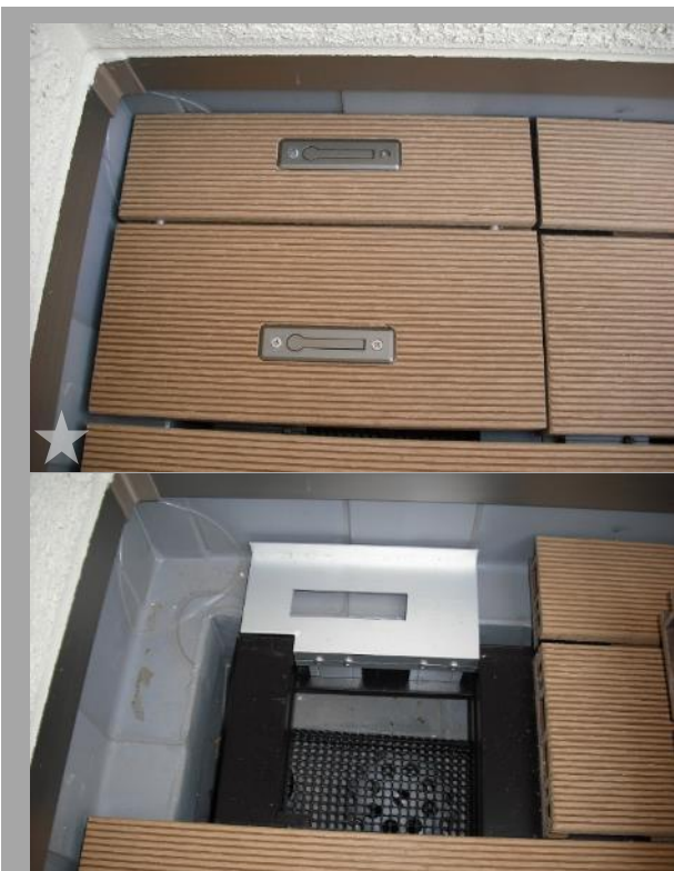
フルフラットバルコニー排水口
