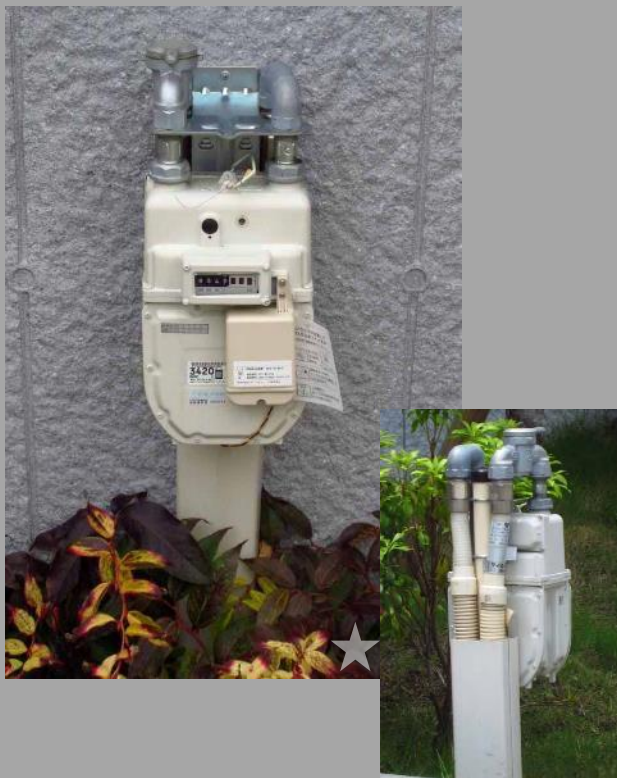
ガスメーター
