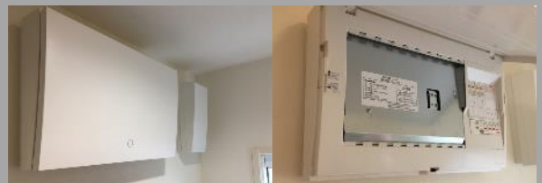
蓄電用分電盤
